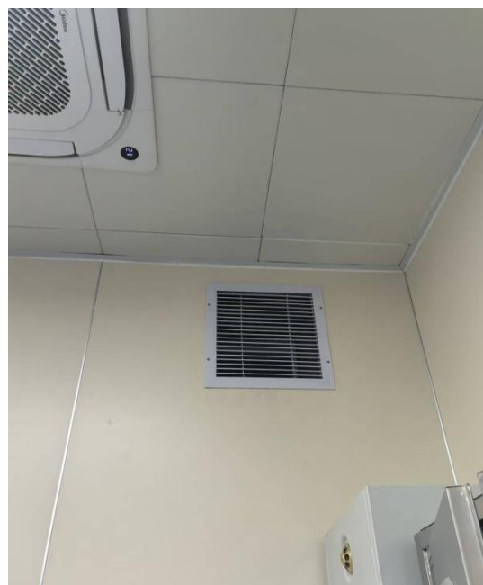
机械排风系统的铅百叶
